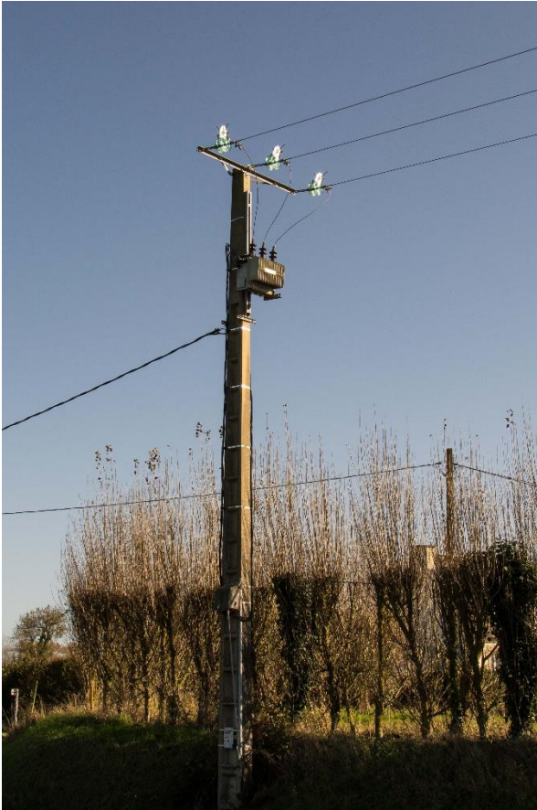
Transformateur 20 kV/220 V
